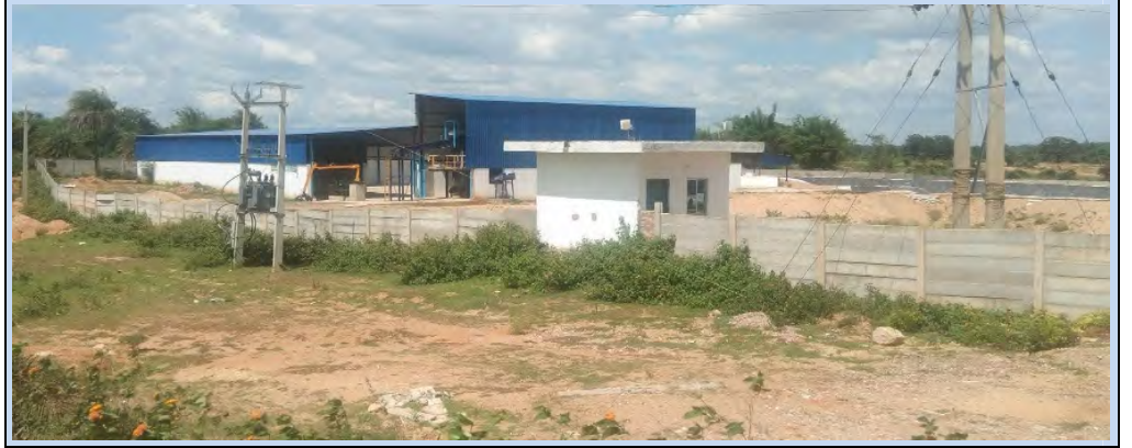
प्रदर्श 7.2: झुमरीतिलैया व कोडरमा क्लस्टर एमसी में ईसी प्राप्त किये बिना निर्माण कार्य (भराव स्थल सहित) (23 नवंबर 2022 को ली गई तस्वीर)
