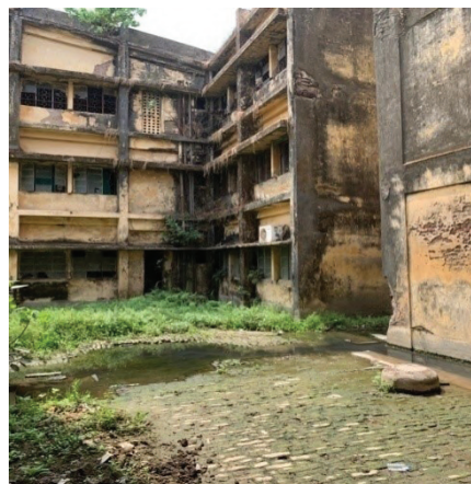
चित्र 5.6: सर्जरी विभाग (डीएमसीएच) का जर्जर भवन (29.03.2022)
