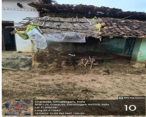
चित्र 4.3: वितरण लाइन नहीं पहुंची एवं कार्यशील घरेलू नल कनेक्शन का निर्माण नहीं किया गया (ग्राम भिथीडिह बस्ती विद्यानगर)
