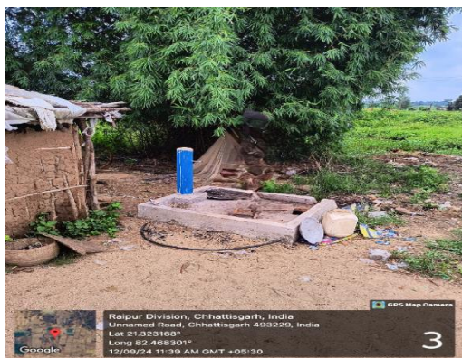
चित्र 4.1: वितरण लाईन के बिना निर्मित कार्यशील घरेलू नल कनेक्शन एवं बिना कनेक्शन के खुला पड़ा कम्पोजिट पाइप (ग्राम भिथीडीह बस्ती कमारडेरा)
