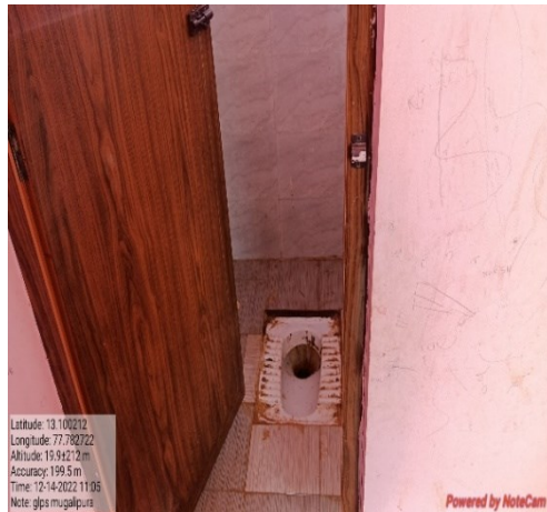
Unhygienic toilet in GLPS Mugalipura
