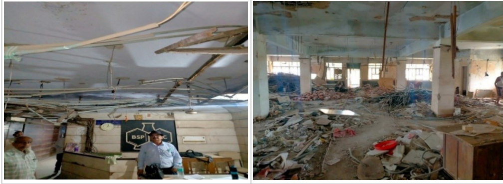
चित्र 4 एवं 5: बिहार स्टेट फार्मास्यूटिकल्स एंड केमिकल डेवलपमेंट कॉरपोरेशन लिमिटेड एवं इसकी छः सहायक कम्पनियों (पाँचवा तल, मौर्य लोक कॉम्प्लेक्स, पटना) के मुख्यालय की जर्जर स्थिति
