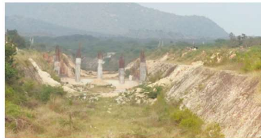
ఫీడర్ కెనాల్ పై అసంపూర్ణ నిర్మాణం
