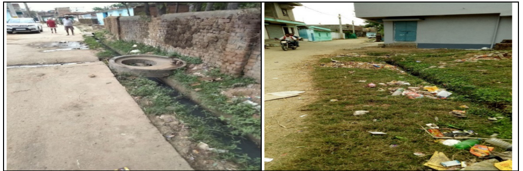
चित्र 3.3 और 3.4: बूटी बस्ती में तूफानी जल निकासी संरचना और नाले के किनारे बिखरा हुआ ठोस कचरा (22 नवंबर 2021)
