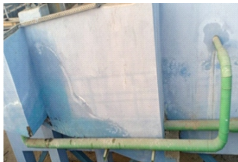
Damp at Beur STP
