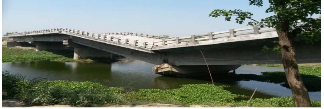
मुजफ्फरपुर में रून्नीसैदपुर-कटरा-केवत्सा पथ पर क्षतिग्रस्त पुल
