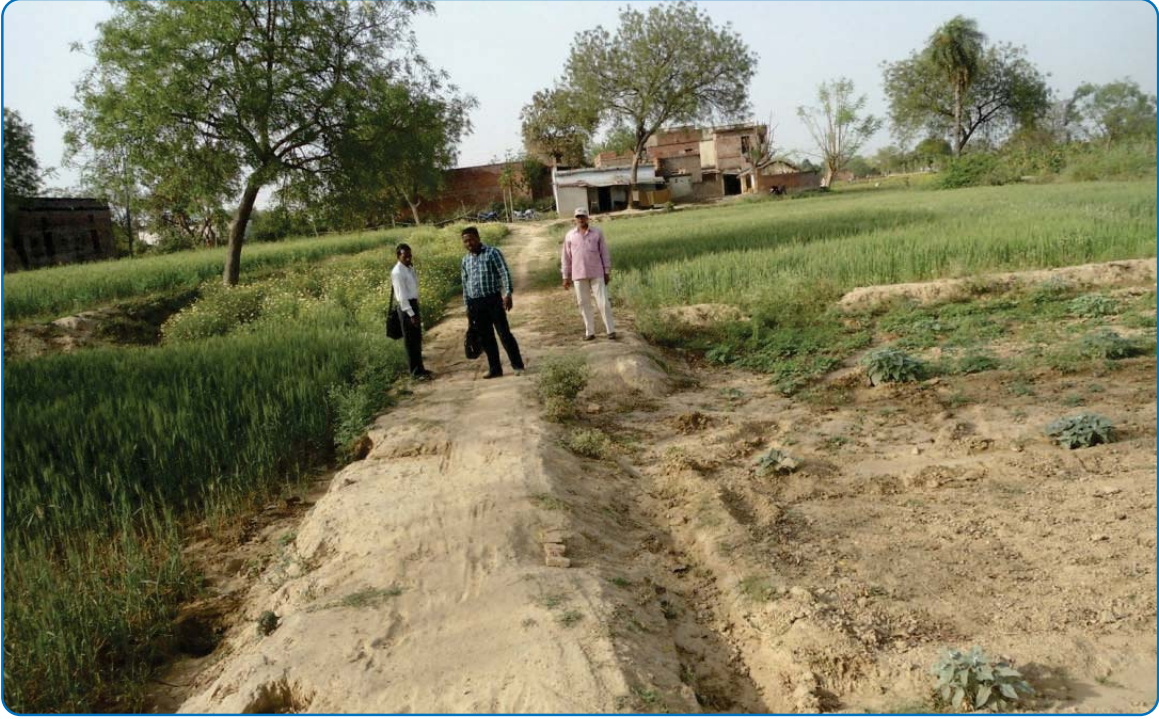
मनरेगस के अंतर्गत निर्मित टूटी हुई मिट्टी की सड़क, ग्राम पंचायत, खालीसपुर, ब्लॉक चिरईगाँव, जिला वाराणसी, उत्तर प्रदेश
