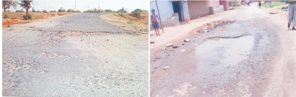
(सड़को के अनुरक्षण न होने के कारण बोकारो जिला में गलगलटांड से अनडीहा सड़क (दायें) और देवघर जिला में नावाडीह से बोनडिया सड़क (बायें) का क्षतिग्रस्त और बदतर अवस्था)
